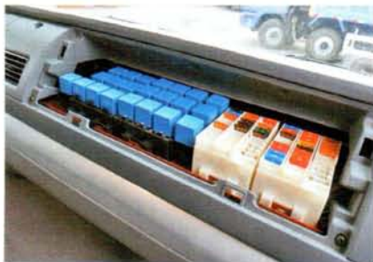
Основной блок предохранителей и реле – под крышкой, напротив пассажира
