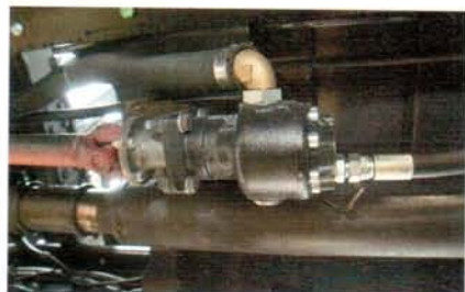
Гидронасос самосвальной установки смонтирован на отдельном кронштейне
