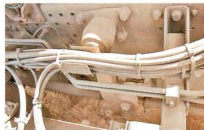
Часть трубок и пучки проводов проложены с внешней стороны рамы
